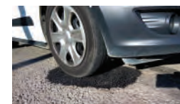
04 Circular Após tapar a área, varrer restos do material à volta para dentro do buraco para finalizar e abrir ao trânsito.
